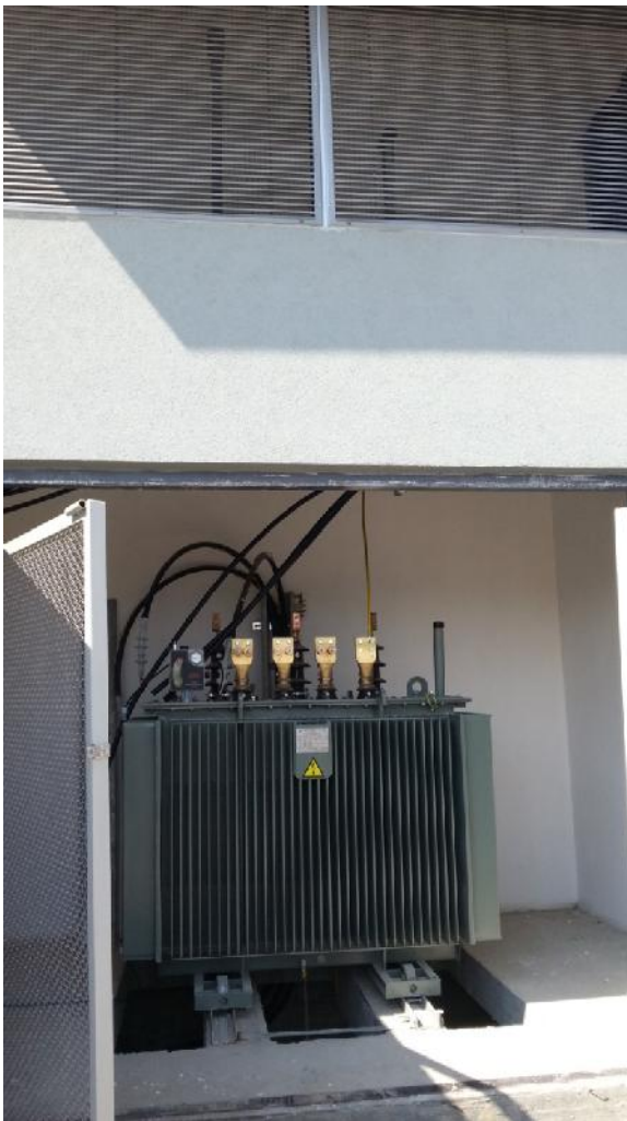
Transformador de servicios auxiliares 1 MVA, 20/0,4 KV
