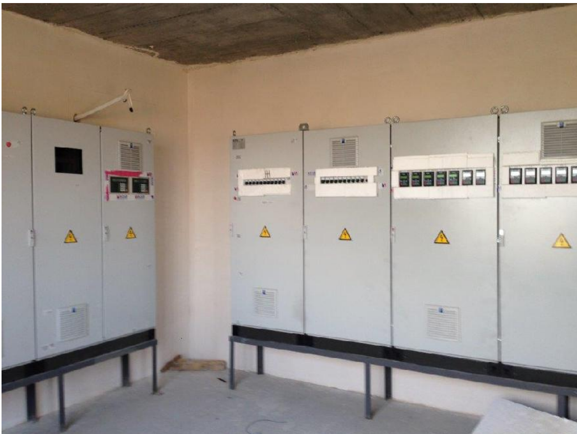
Cuadros eléctricos planta de gasificación
