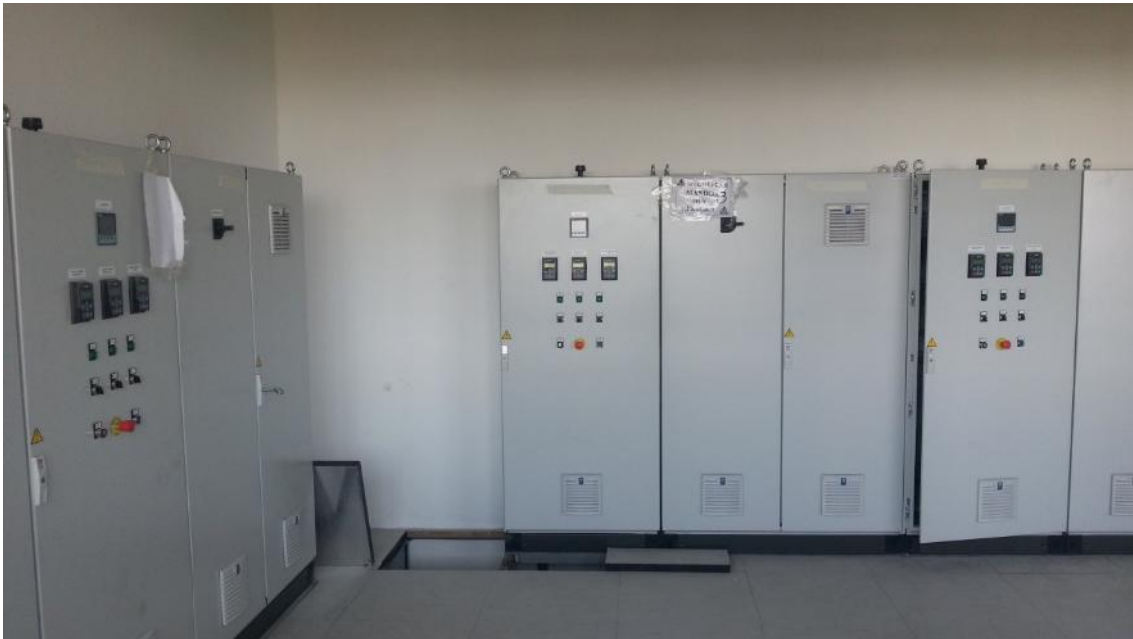
Sala de control y cuadros eléctricos de cogeneración
