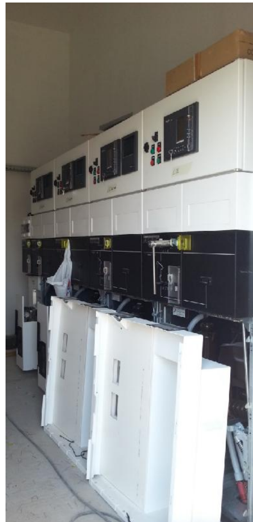
Cabinas de media tensión en montaje
