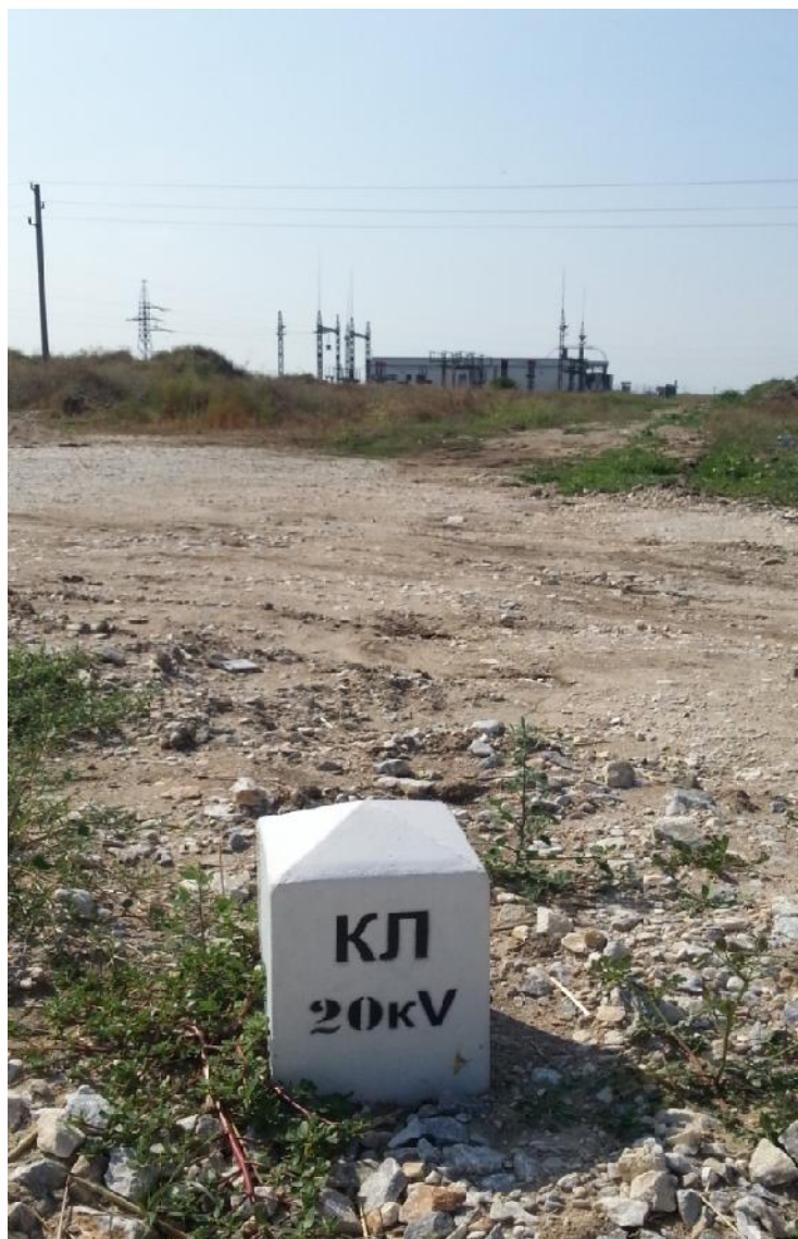
Señalización de la nueva línea eléctrica subterránea que llega hasta la subestación eléctrica.
