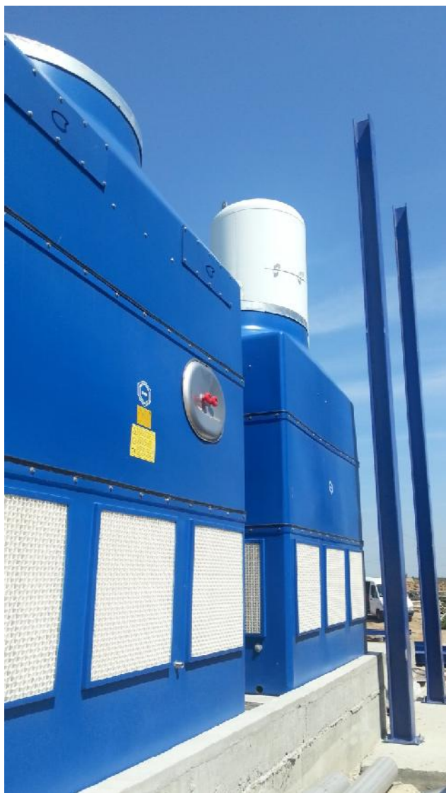
Torres de Refrigeración del sistema de refrigeración de la planta de generación de electricidad.
