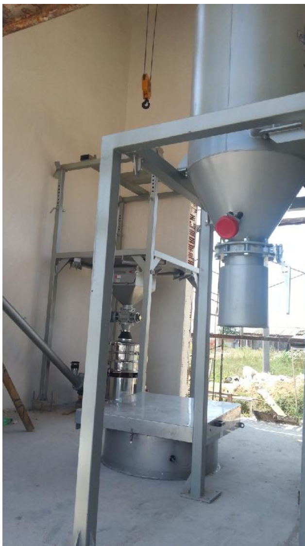
Equipos del transporte neumático
