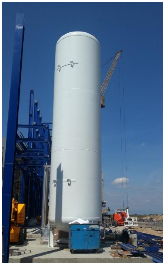
Depósito de Nitrógeno
