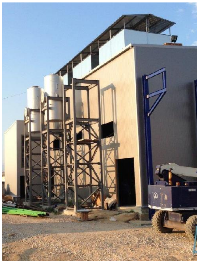
Vista general de los silenciadores de escape y del sistema de ventilación sala motogeneradores.
