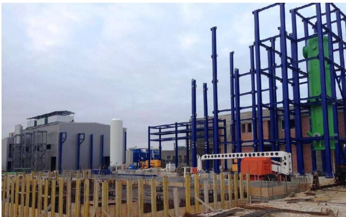
Vista general planta de generación de electricidad, isla de gasificación en primer término.
