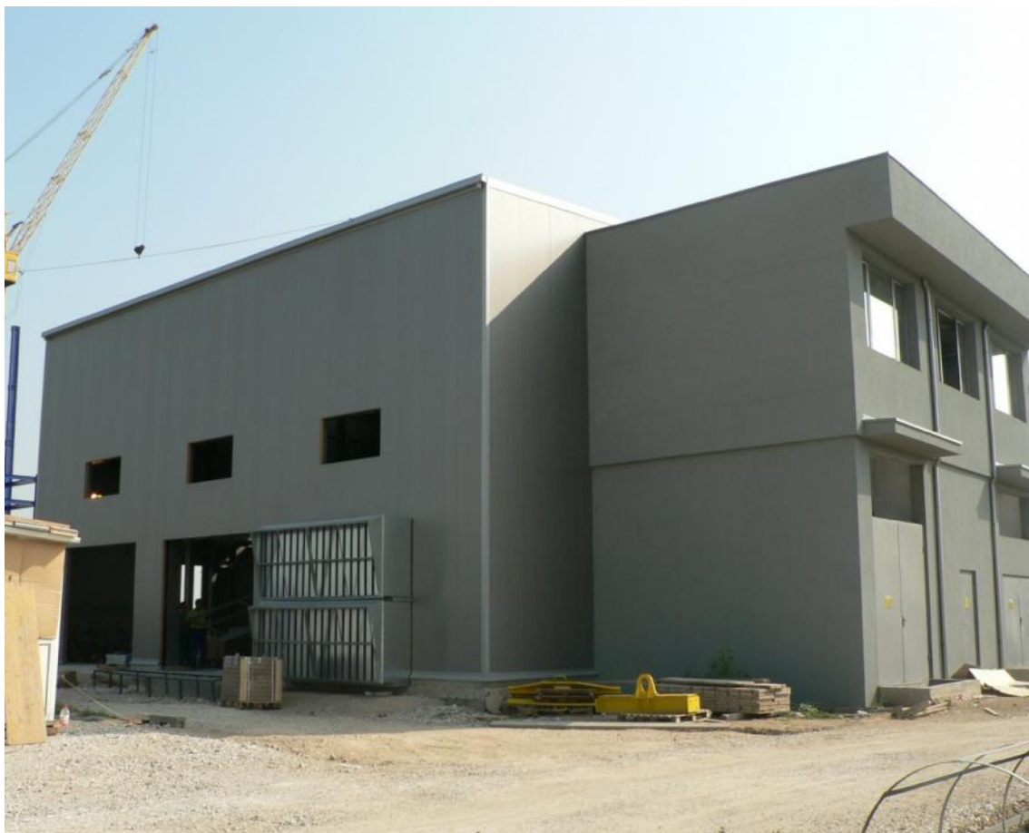
Edificio Principal de la planta compuesto por sala de motogeneradores, estación transformadora y sala de control.
